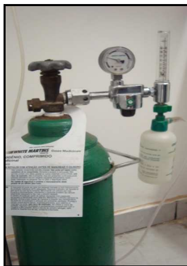
Figura 12: Equipamento Reservatório de Oxigênio Fonte: Lôbo (2012)
